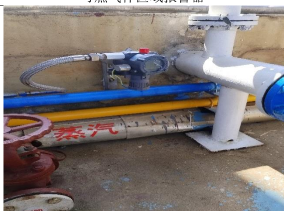
泵棚的可燃气体检测报警装置
