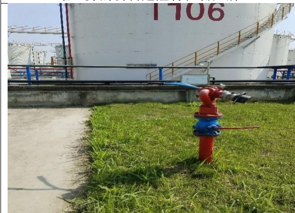
罐组旁的消防水炮
