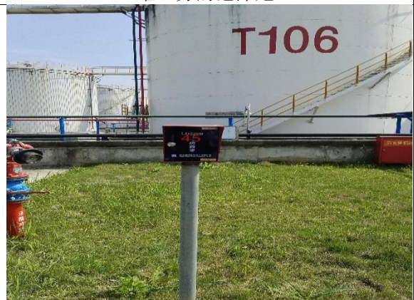
罐组旁的手动报警按钮
