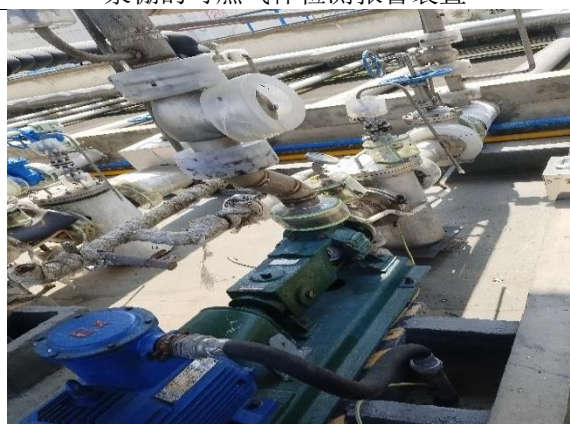
泵棚使用的泵均为防爆泵
