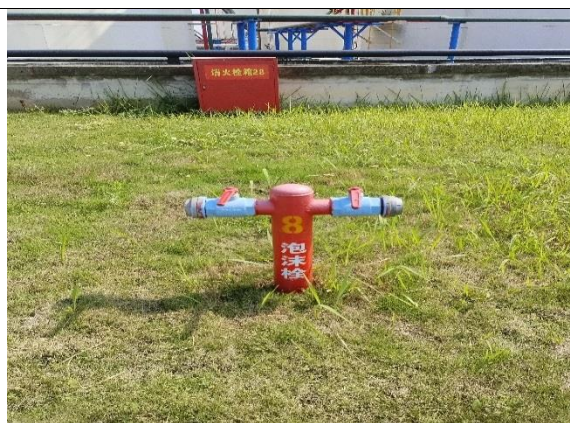
罐组旁的泡沫栓
