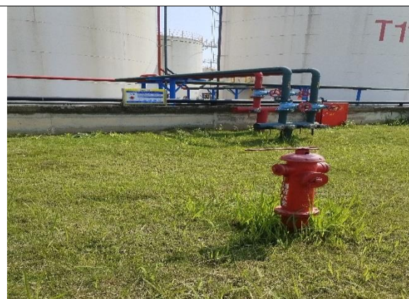
罐组旁的消防水栓
