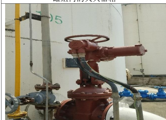
储罐的紧急切断阀
