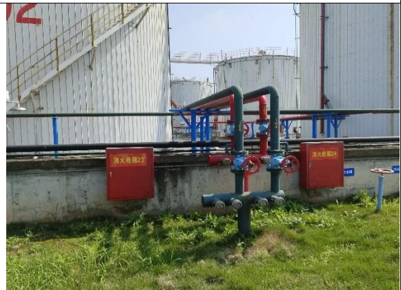
进入罐组的消防喷淋管道及泡沫管道
