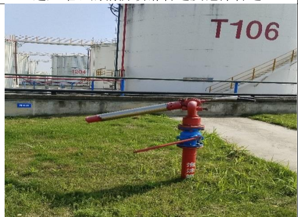
罐组旁的泡沫炮
