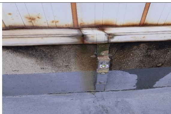
储罐的接地点
