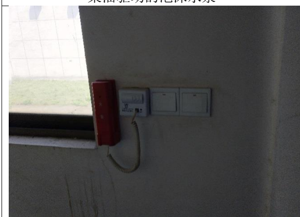
变电所内的消防电话
