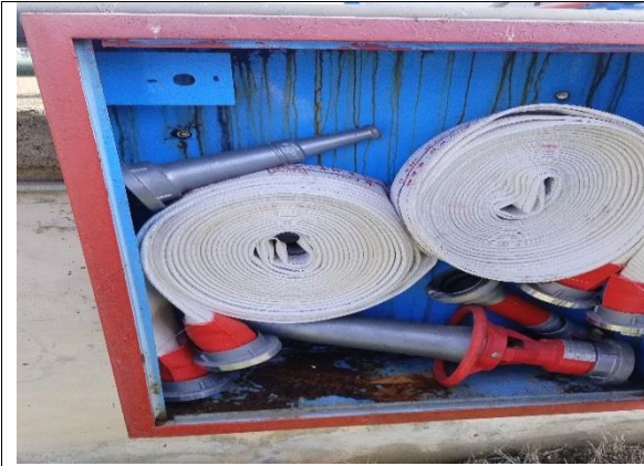
罐组旁的消防箱内的水带、水枪及泡沫枪
