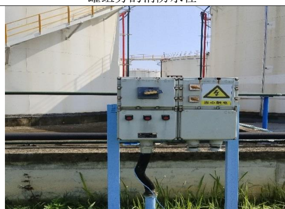
罐组旁的防爆检修箱
