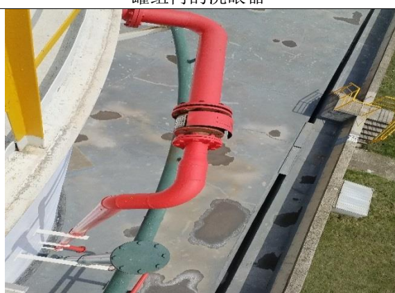
储罐的泡沫管及喷淋管
