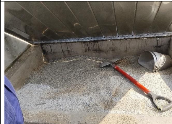
罐组外的消防沙箱、消防桶、消防铲
