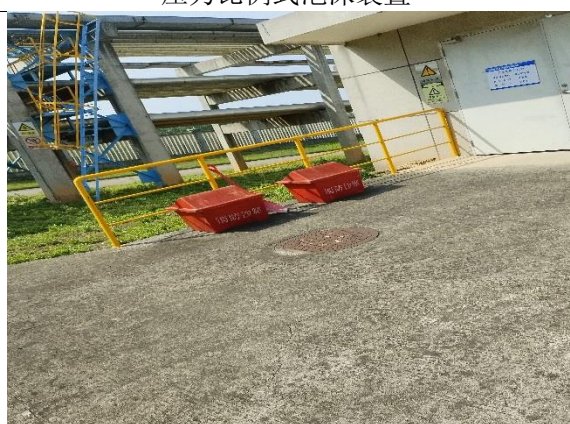
变电所入口处的消防砂
